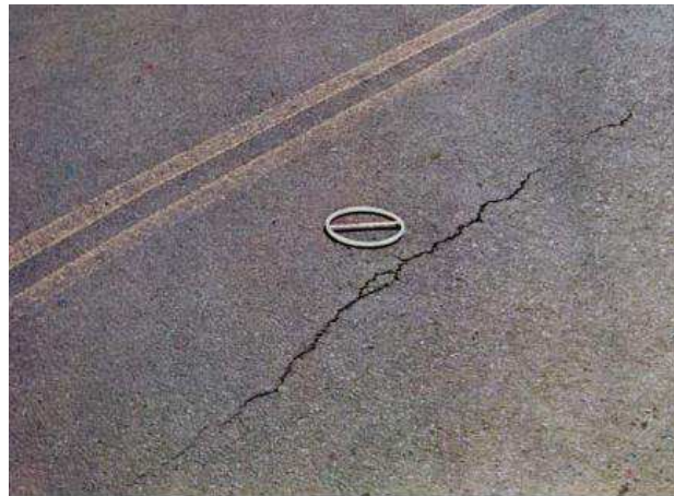
Figura 5 – Trinca isolada longitudinal
