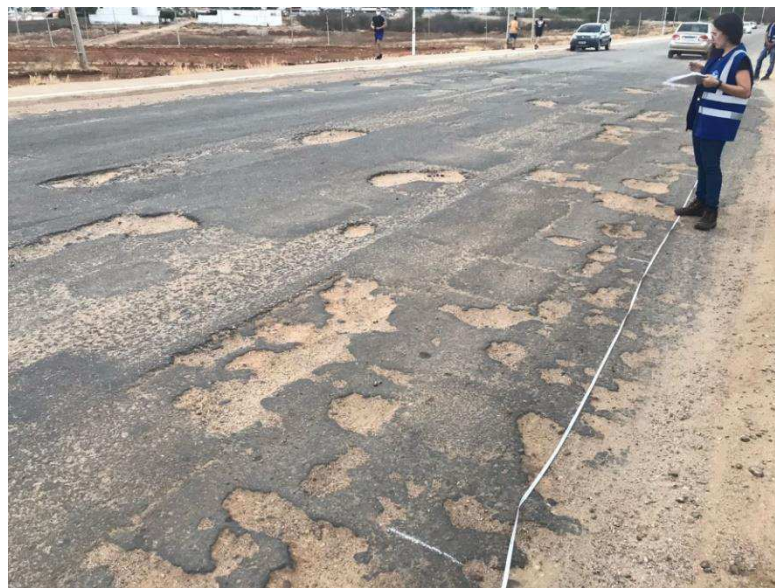
Figura 21 – Análise dos defeitos encontrados
