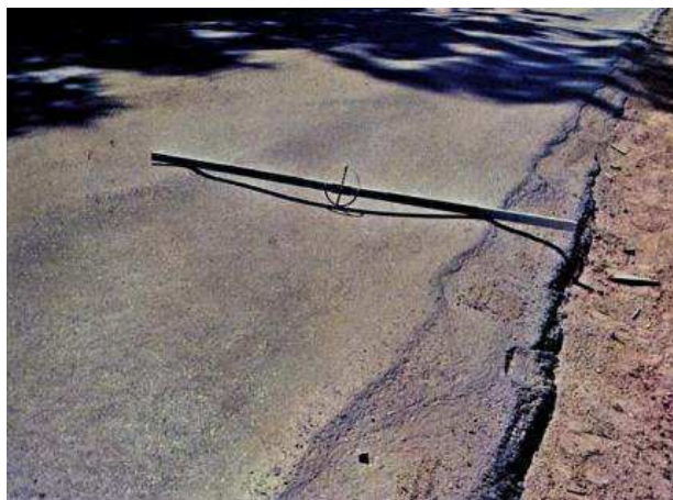
Figura 9 – Afundamento de trilha de roda
