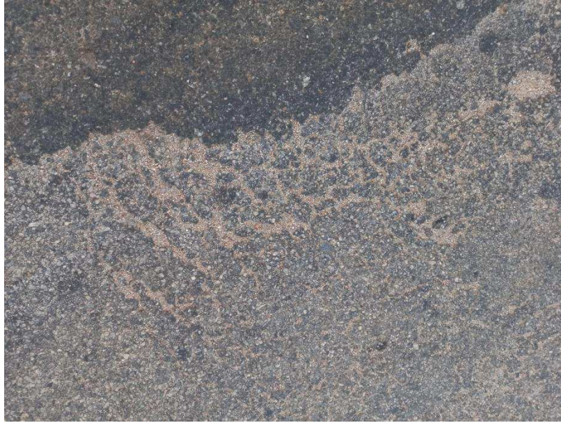
Figura 25 – Trinca couro de jacaré com erosão acentuada nas bordas
