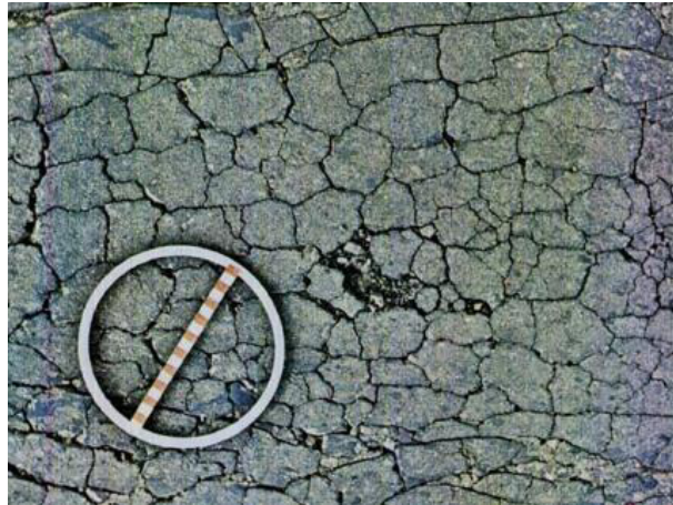
Figura 6 – Trinca interligada do tipo couro de jacaré
