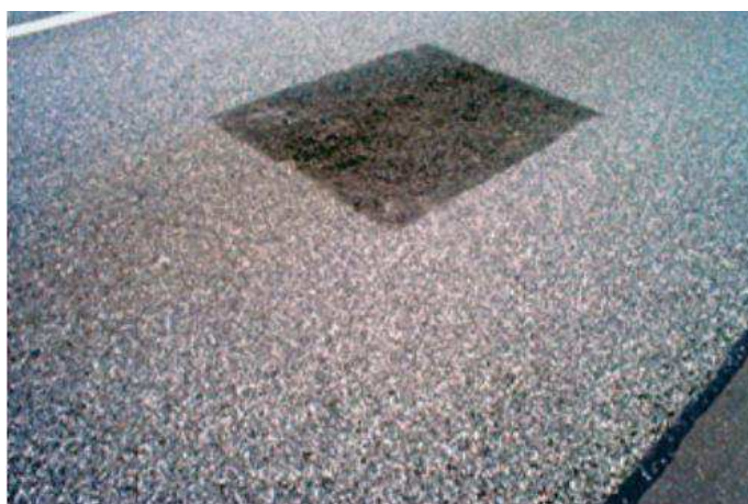
Figura 15 – Remendo bem executado
