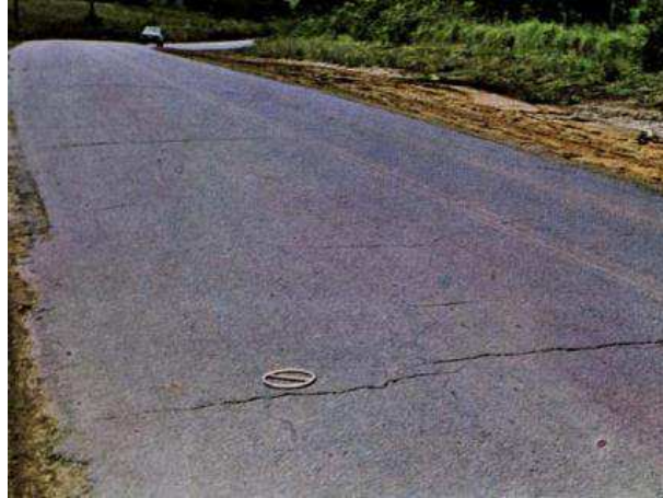
Figura 4 – Trinca isolada transversal
