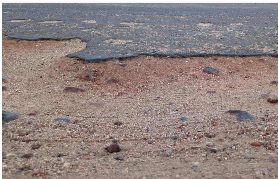
Figura 23 – Exposição de camadas sob o revestimento betuminoso
