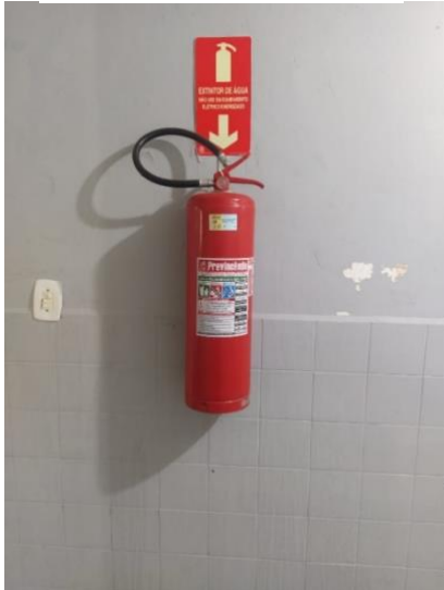
A - Capacidade Extintor 2-A
