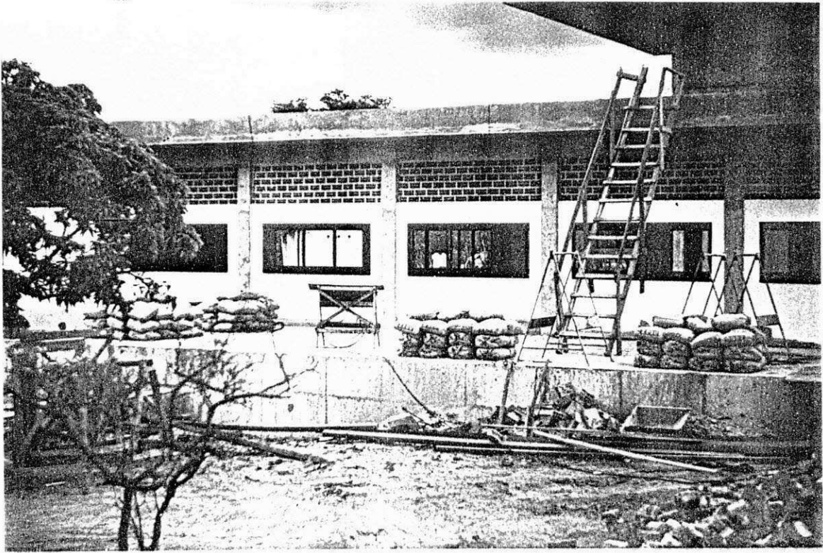
Casa de Bombas
