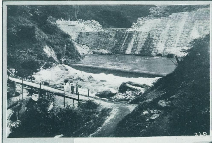
Açude Acarapé. — Aspecto da barragem em construção, vista do lado á jusante.
