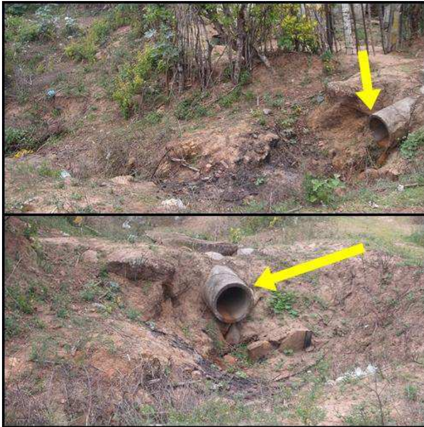
Figura 19 A e B - Lançamento de águas servidas diretamente no solo, potencializando a erosão linear e encharcamento do solo
