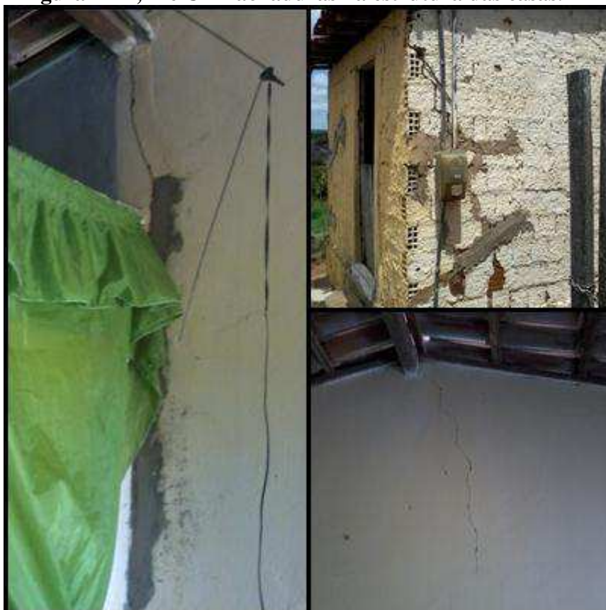
Figura 14 A, B e C - Rachaduras na estrutura das casas.
