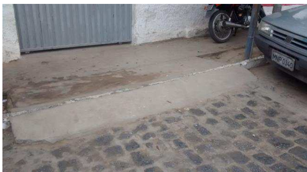
MOURA, 2014 – E.E.E.F.M. Dep. Carlos Pessoa Filho – Rampa de acesso (precária) na entrada da escola.
