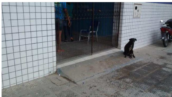
MOURA, 2014 – E.M.E.F. Jardirene Oliveira de Souza – Rampa de acesso (precária) na entrada da escola.
