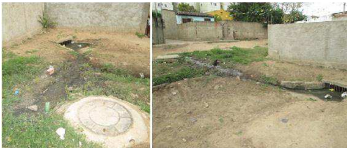
Figura 8 – Esgoto estourado vindo do condomínio fechado para cair no açude, no entorno do açude Bodocongó: comunidade Vila dos Teimosos, em Campina Grande-PB
