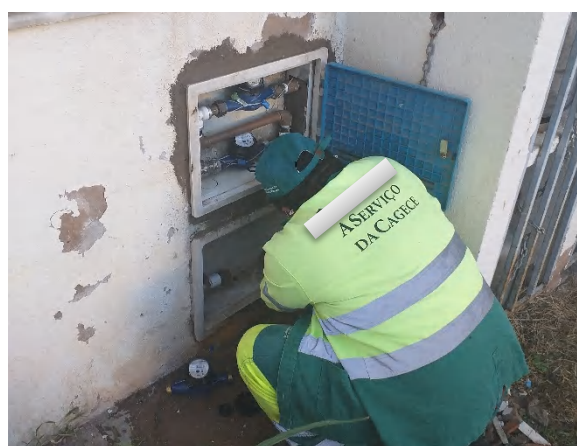
(B) Instalação do medidor em série
