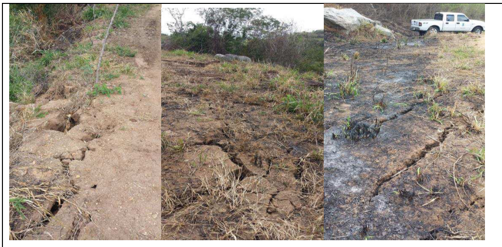
Figura 43 - Rachaduras como indicadores de movimento do tipo rastejo do solo (P1). Fotos: Autor (2017);
