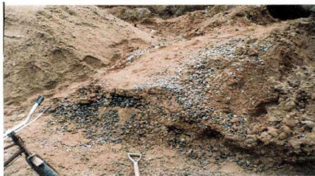
figura 06 – desperdício de materiais de construção
