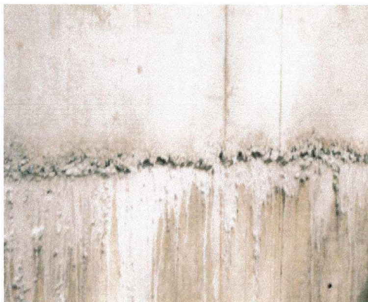
figura 23 – segregação do graúdo e vazamento da nata
