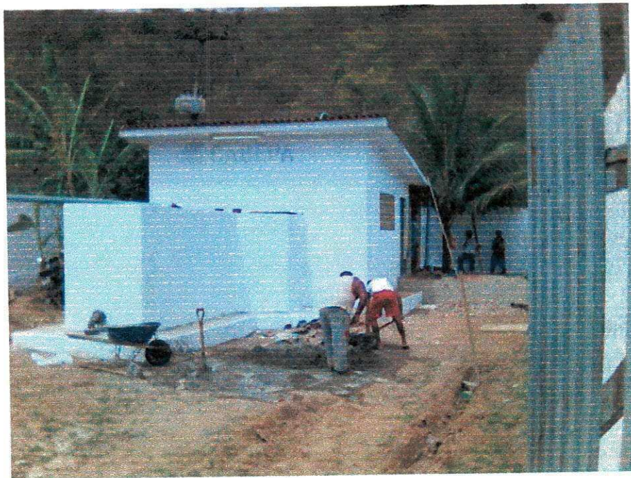
Fig.2 - Estação de tratamento de água bruta Massaranduba.
