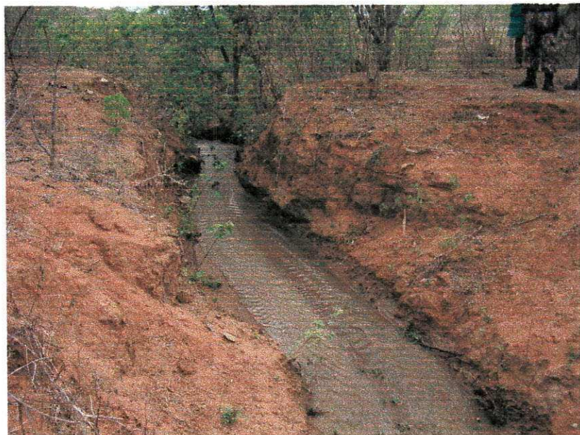
Fig.5 – Caminho percorrido pela água, devido à abertura.
