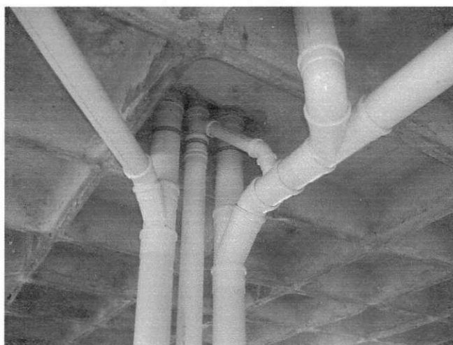
Figura 81 – Instalações hidráulicas da obra
