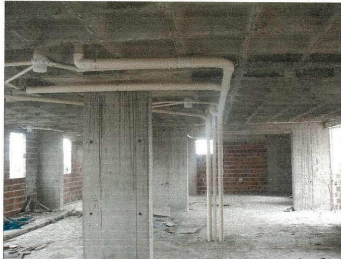
Figura 82 – Instalações hidráulicas de um dos apartamentos da obra
