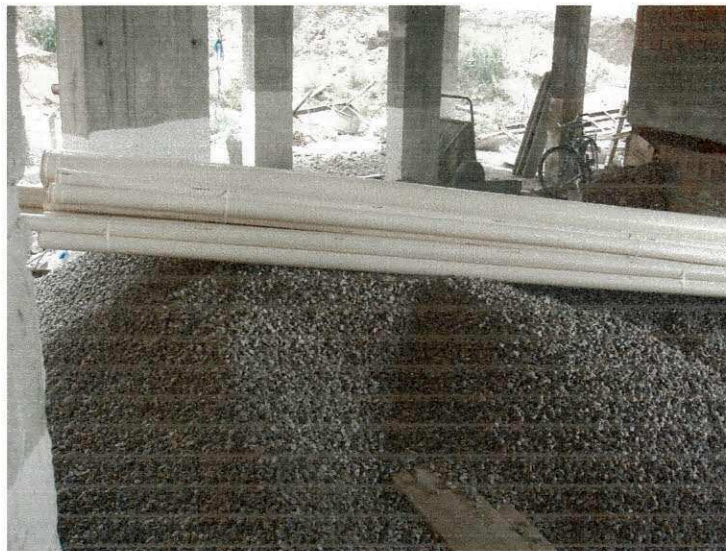
Figura 17 – Brita da obra
