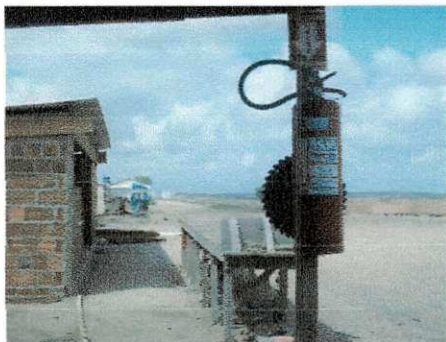
Foto 20: Instintor de Incêndio
