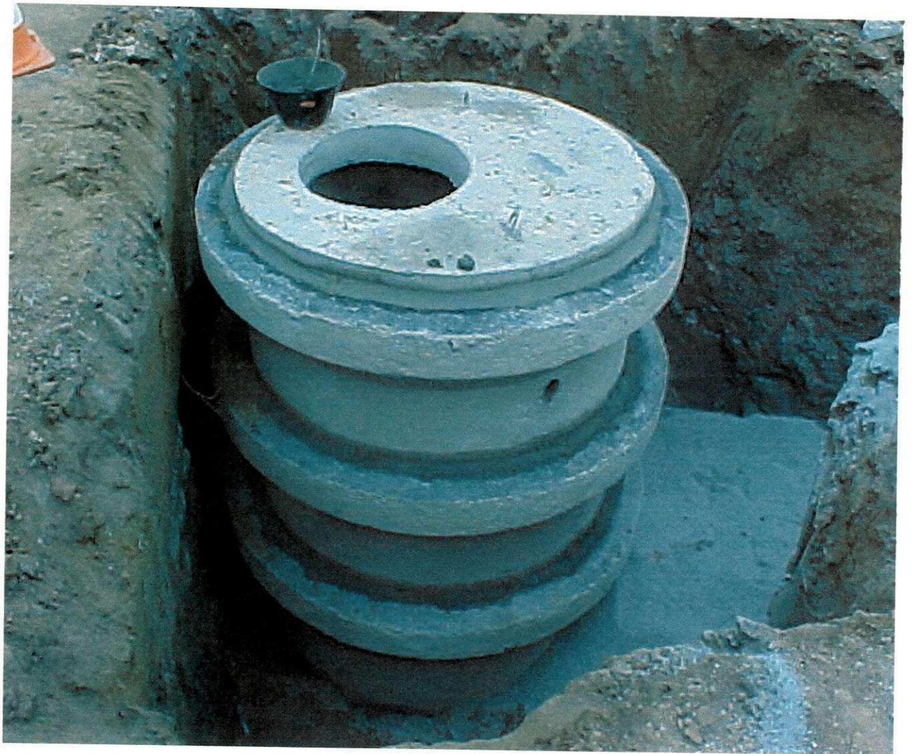
FIGURA 3 - Poço de visita (PV)
