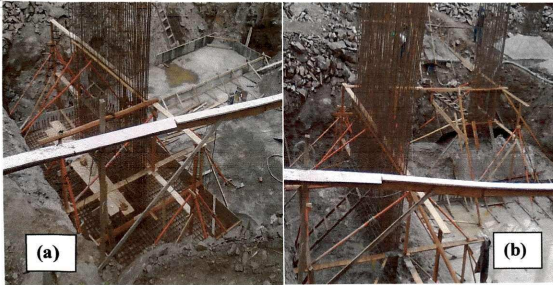
Figura 7. Fotos mostrando a colocação da armadura de espera do pilar de contravetamento (a) e concretagem da sapata corrida (b).
