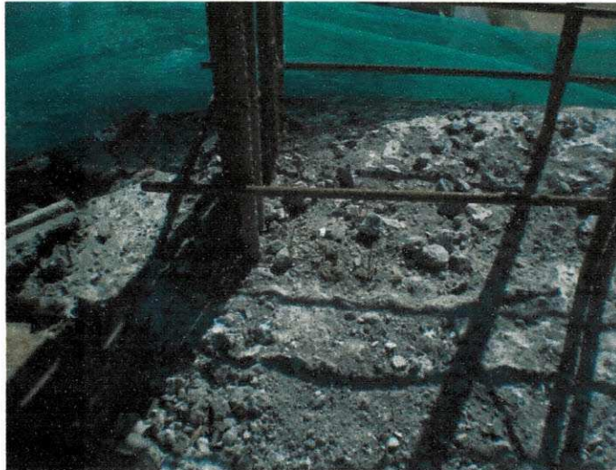
Figura 1 – Gastalho do pilar.
