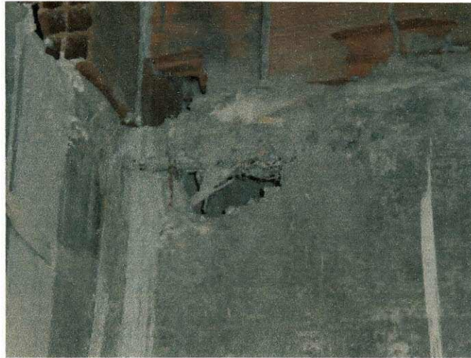
Figura 12 – Foto de uma viga mal concretada.
