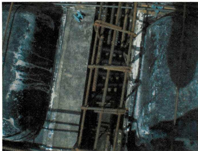
Figura 6 – Canos onde irão passar fios elétricos pelas vigas.
