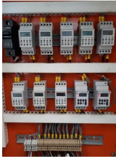
Figura 4.2 – Painel elétrico com temporizadores programados
