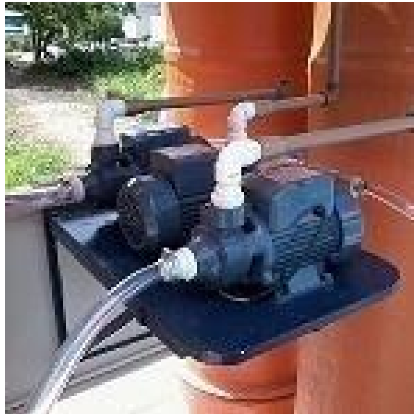
Figura 4.6– Bomba de descarte do efluente.
