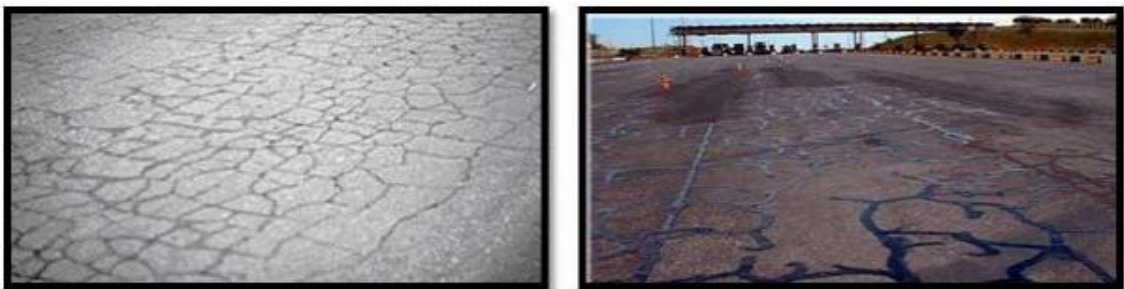
Figura 2: Trincas por fadiga
