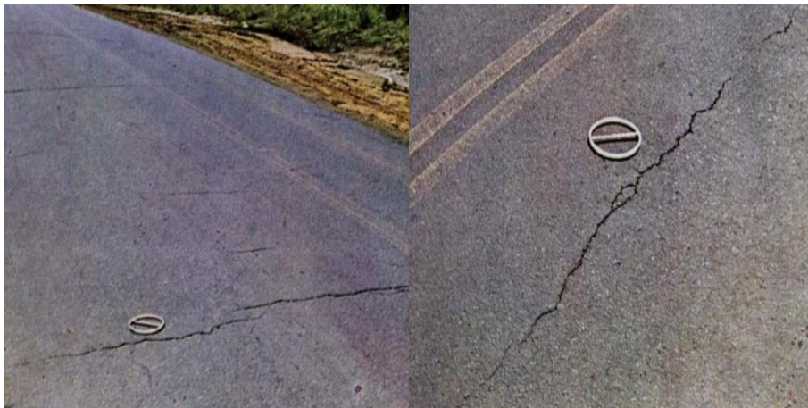
FIGURA 3 – TRINCA TRANSVERSAL VERSUS TRINCA LONGITUDINAL.
