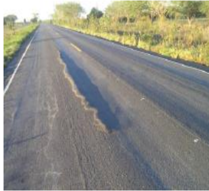
FIGURA 5 – AFUNDAMENTO EM TRILHA DE RODA.
