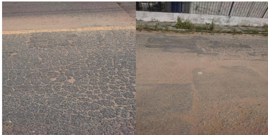
FIGURA 19 – FISSURAS E REPARAÇÕES
