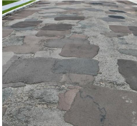
FIGURA 10 – REMENDO MAL EXECUTADO.
