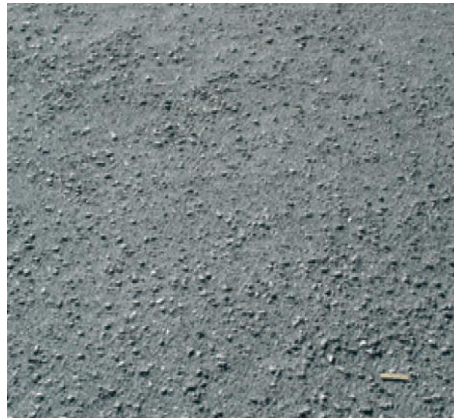
FIGURA 8 – DESGASTE DO PAVIMENTO.
