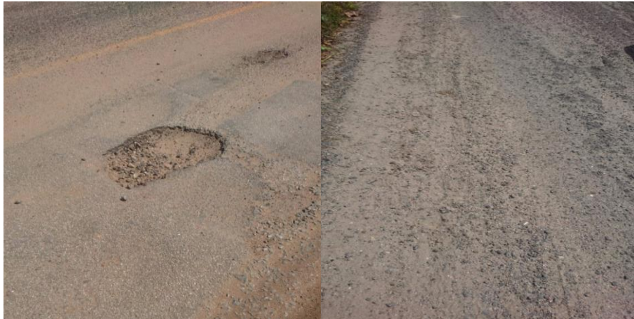
FIGURA 20 – PANELAS E DESGASTE.
