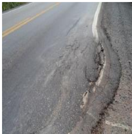
FIGURA 11 – ESCORREGAMENTO DO REVESTIMENTO.
