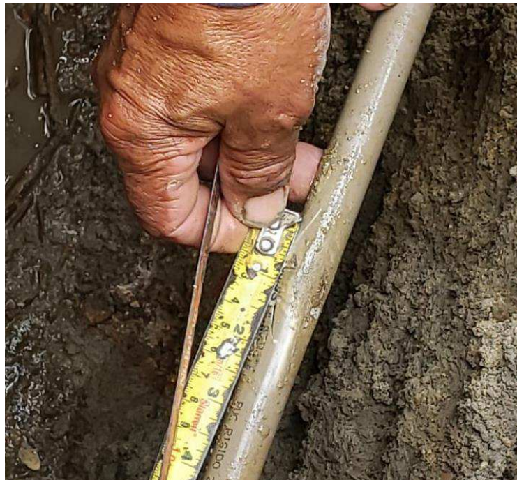
Figura 18: Vazamento na tubulação - Rachadura
