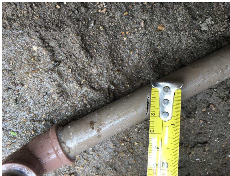
Figura 16: Vazamento na tubulação - Corte
