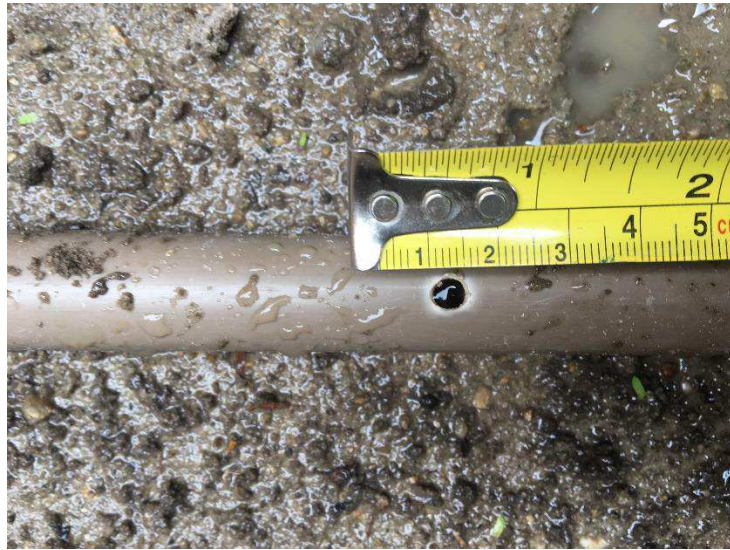
Figura 17: Vazamento na tubulação - Furo
