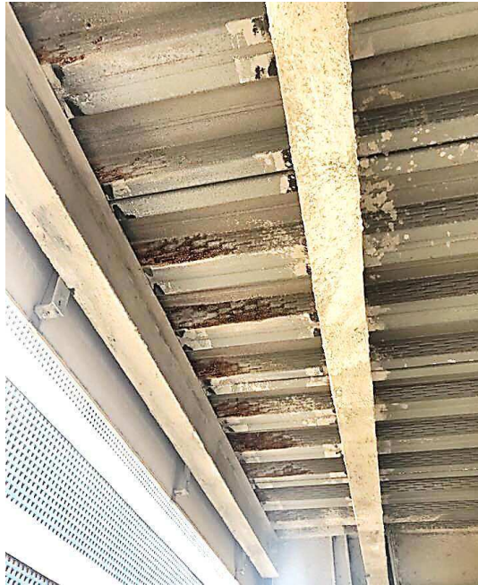
Figura 20 - Corrosão em telha galvanizada
