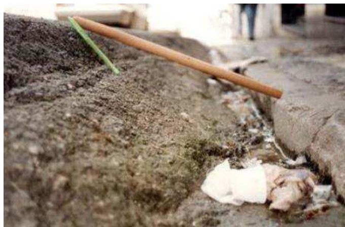
Figura 4 – Sobreposição de revestimentos asfálticos sem a retirada das camadas anteriores
