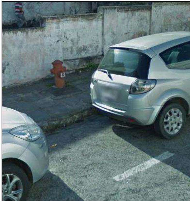
Figura 10 - Hidrante localizado na rua Getúlio Vargas no centro de Campina Grande - PB.
