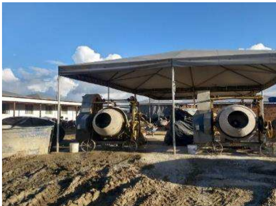
Figura 11 - Setor de betoneiras
