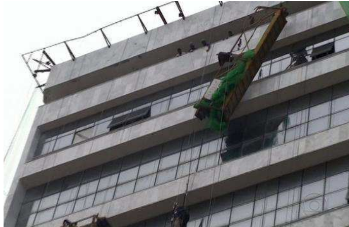
Figura 6 - Rompimento de cabo de sustentação em andaime suspenso
