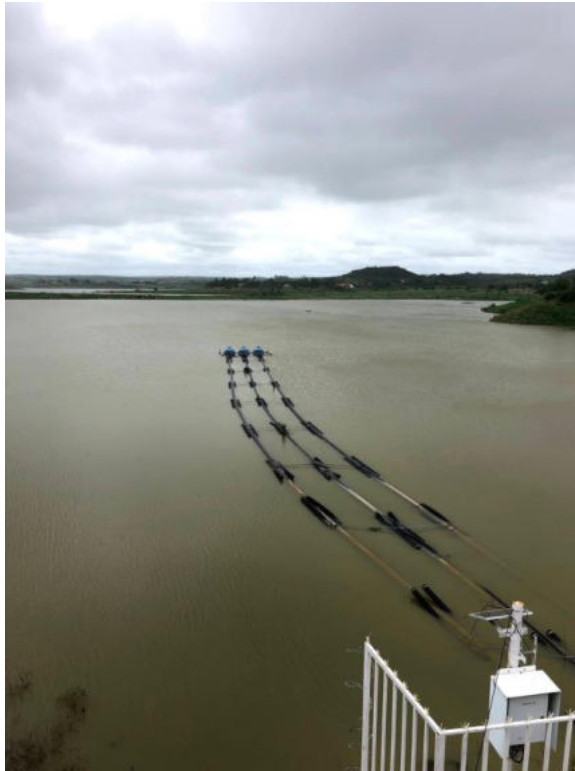
Figura 3 - Captação por bombas flutuantes no Açude de Boqueirão
