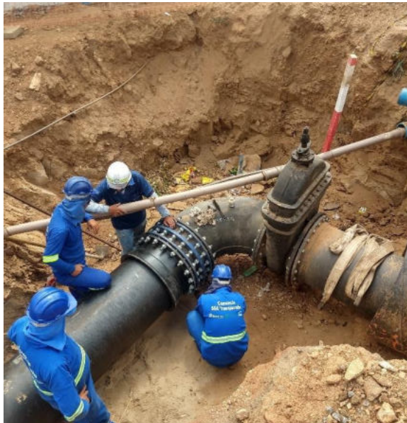
Figura 4 - Adutora Transparaíba - Trecho em estudo com peças especiais – Boqueirão - PB
