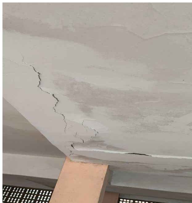
Figura 5 - Trinca laje térreo – lado direito.
