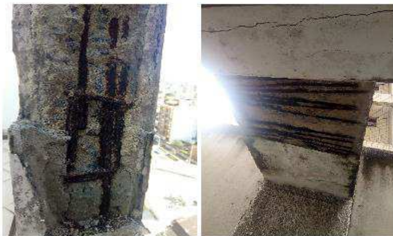
Figura 3 – Corrosão de armadura
