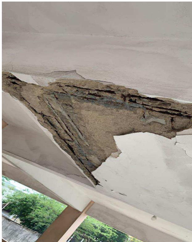
Figura 7 - Queda do cobrimento da armadura da laje / Corrosão da armadura – lado esquerdo.
