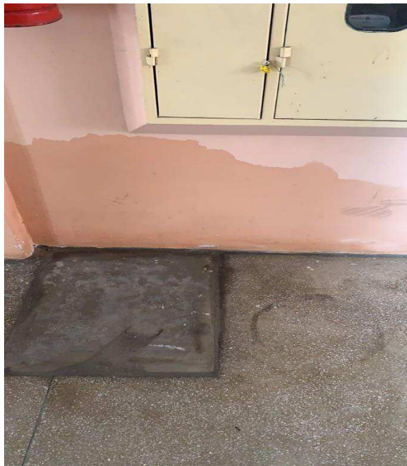
Figura 9 - Umidade ascendente – hall
