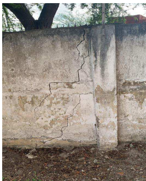
Figura 11 - Trinca parede do muro lateral
