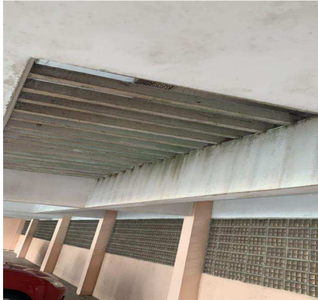
Figura 4 - Trinca laje térreo – lado direito.
