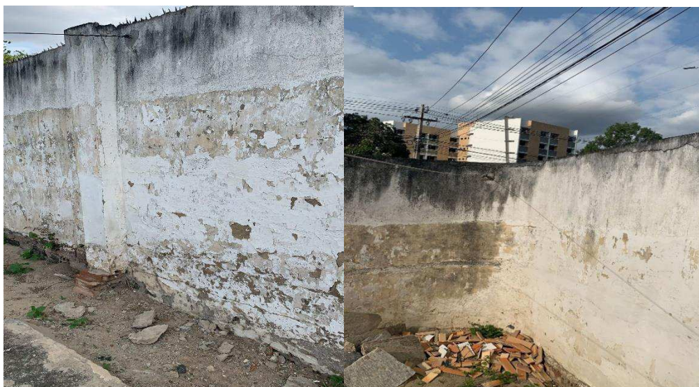
Figura 12 - Manchas e descascamento da pintura- área externa
