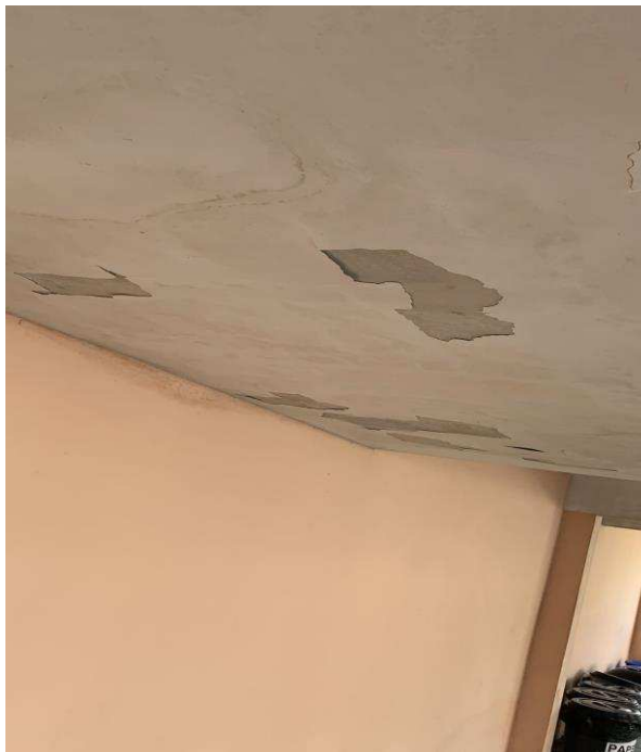
Figura 8 – Bolor / infiltração – laje lado esquerdo
