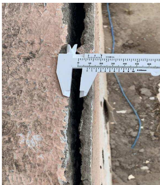
Figura 10 – Trinca área externa
