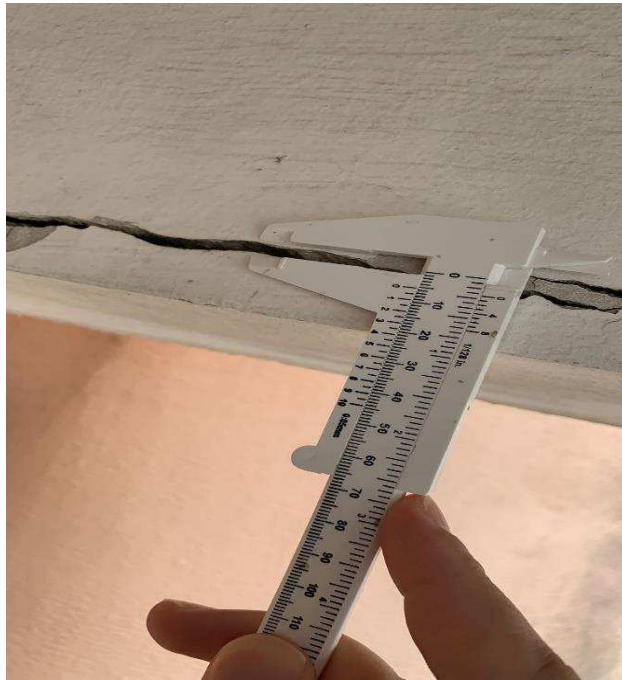
Figura 6 - Rachadura viga- lado direito.
