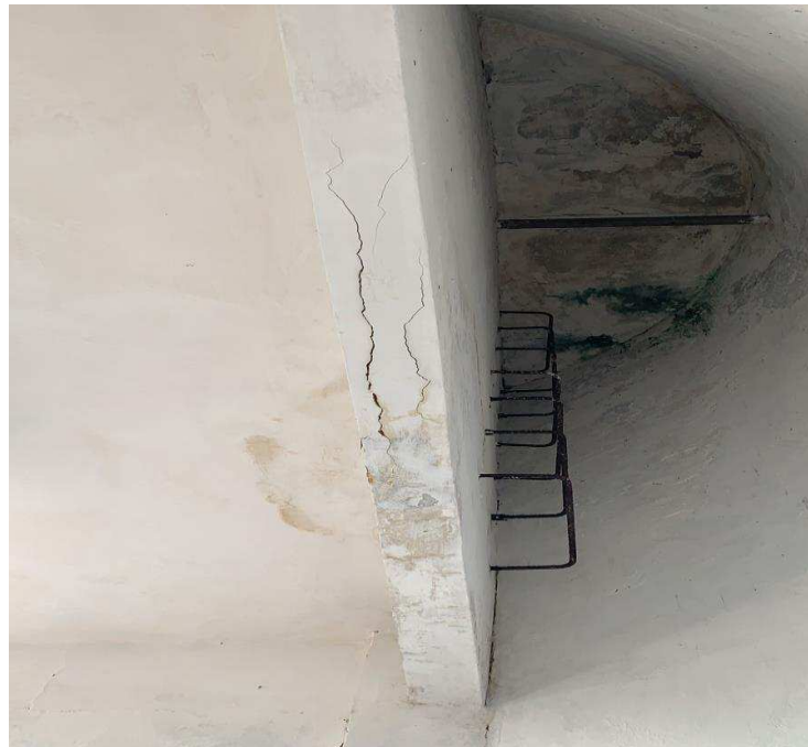
Figura 13 – Eflorescência na laje do 3º andar
