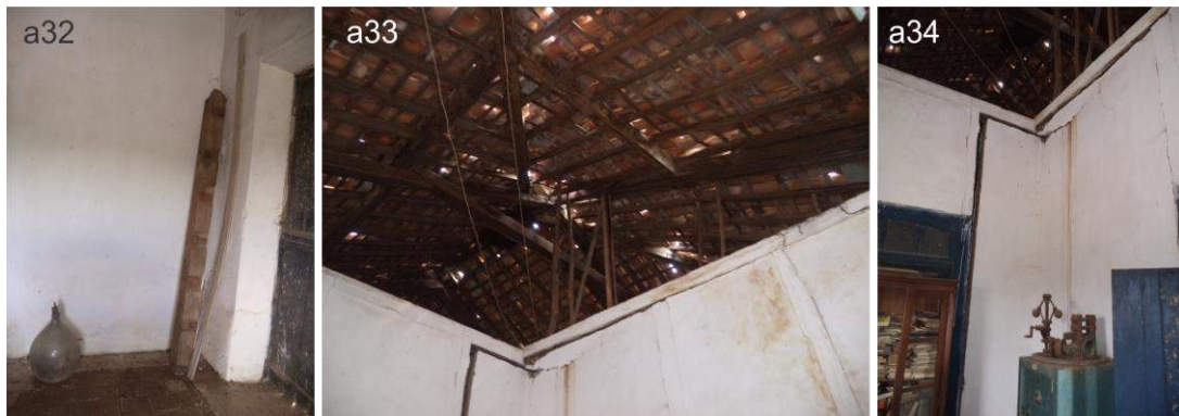
Figura 47 - Comprometimento da estrutura do telhado. a32 - peça de madeira que caiu; a33 - escoras de madeira; a34 - fissuras nas paredes provocadas pelo escoramento do telhado.
