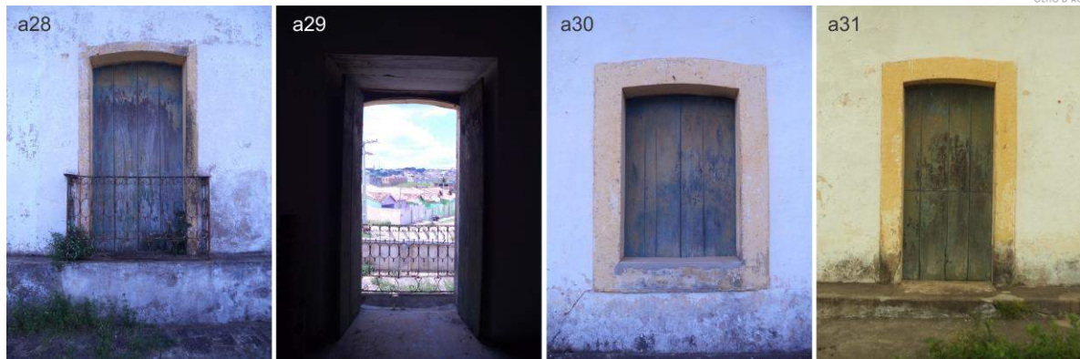
Figura 45 - Esquadrias Construção Original casa-grande. a28 - porta-balcão com gradil de ferro fundido; a29 - visão da porta balcão a partir de uma das salas; a30 – janela; a31 – porta holandesa . Fonte: Acervo do autor, 2016.
