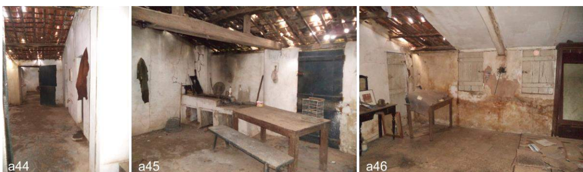
Figura 51 – Acréscimos 1 e 2 da casa-grande internamente. a44 – vista do corredor que conecta a Construção Original aos Acréscimos 1 e 3; a45 – cozinha; a46 - quarto.
