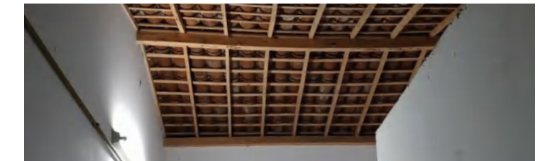
FIGURA 10: Telhado da CC do Jeremias.
