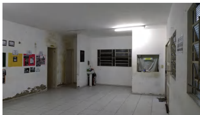
FIGURA 12: Infiltração e descamação sala de distribuição - CC Jeremias FONTE: Autora, 2021.
