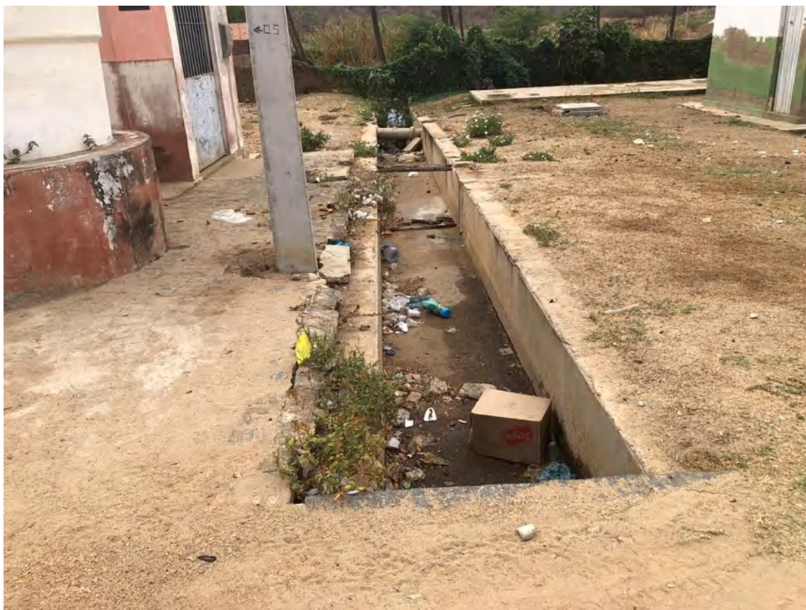
Figura 86 - Precariedade da infraestrutura.
