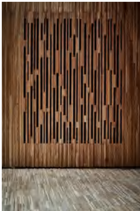
Figura 3.12: Sistema de sonorização embutido nos painéis móveis difusores.
