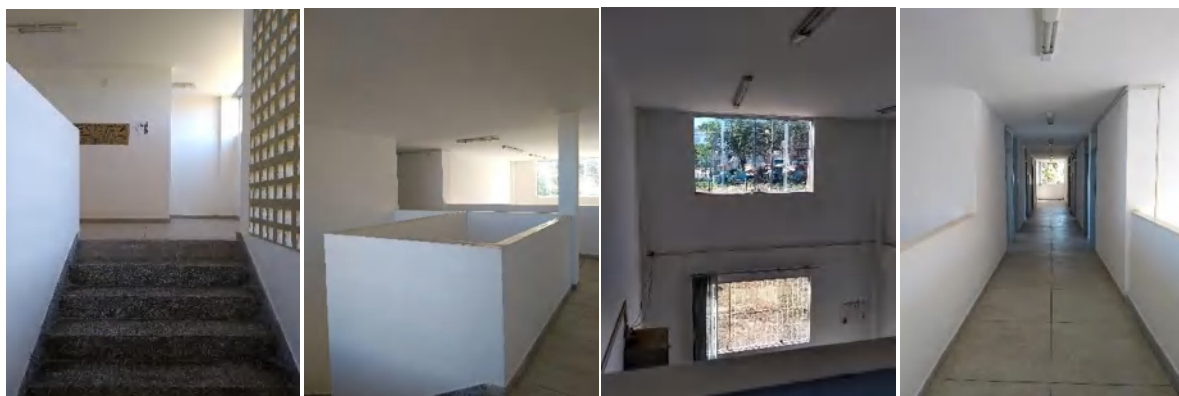
Figuras 70, 71, 72 e 73 . Final da escada no pav. superior, vista da escada, vista do mezanino e corredor de circulação Fonte: Acervo pessoal (2019)
