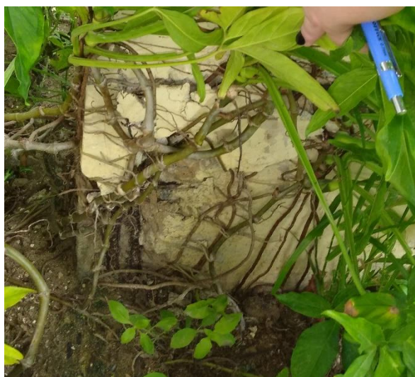
Figura 11: Ataque biológico a pilar de concreto armado
