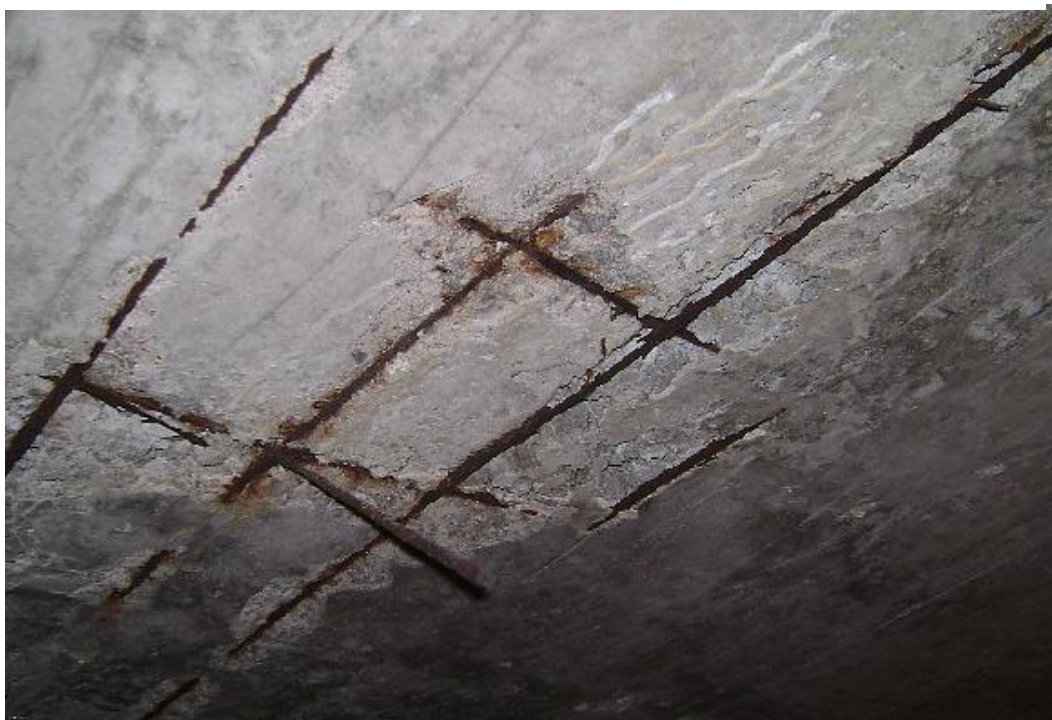
Figura 10: Corrosão em armaduras de laje
