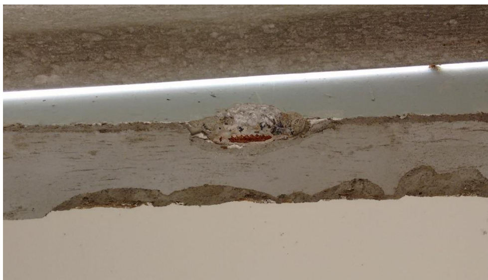
Figura 35: Manifestação patológica em viga do Bloco CA
