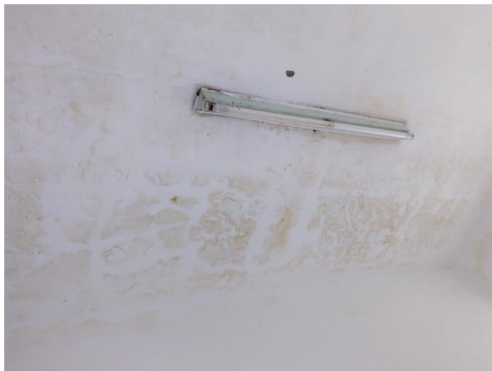
Figura 34: Manifestação patológica em laje do Bloco CA
