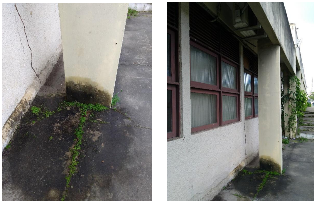
Figura 28: Manifestação patológica no pilar 15 do Bloco CS
