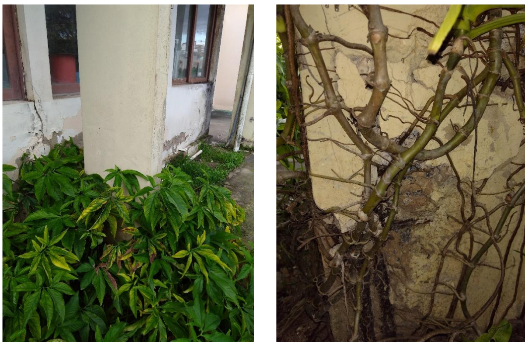
Figura 26: Ataque biológico ao pilar 31 do Bloco CS
