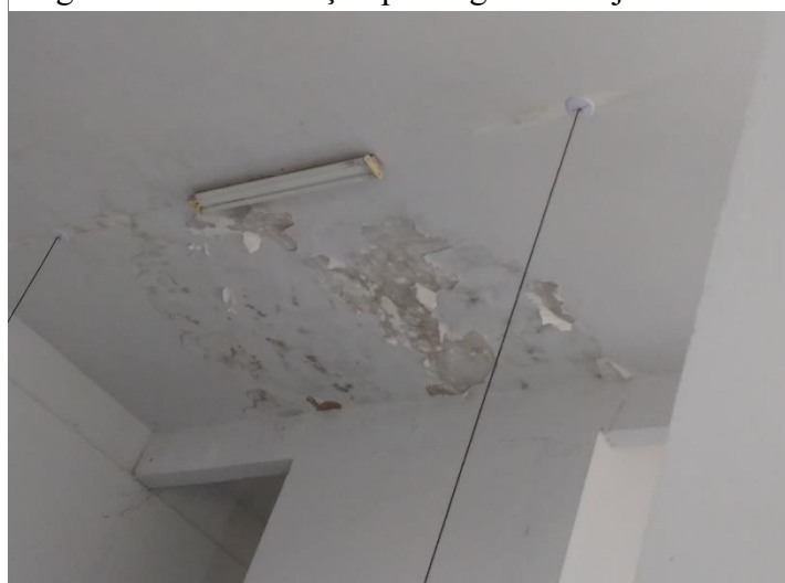
Figura 31: Manifestação patológica em laje do Bloco
