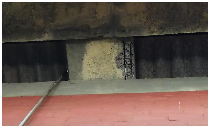
Figura 30: Manifestação patológica em viga do Bloco
