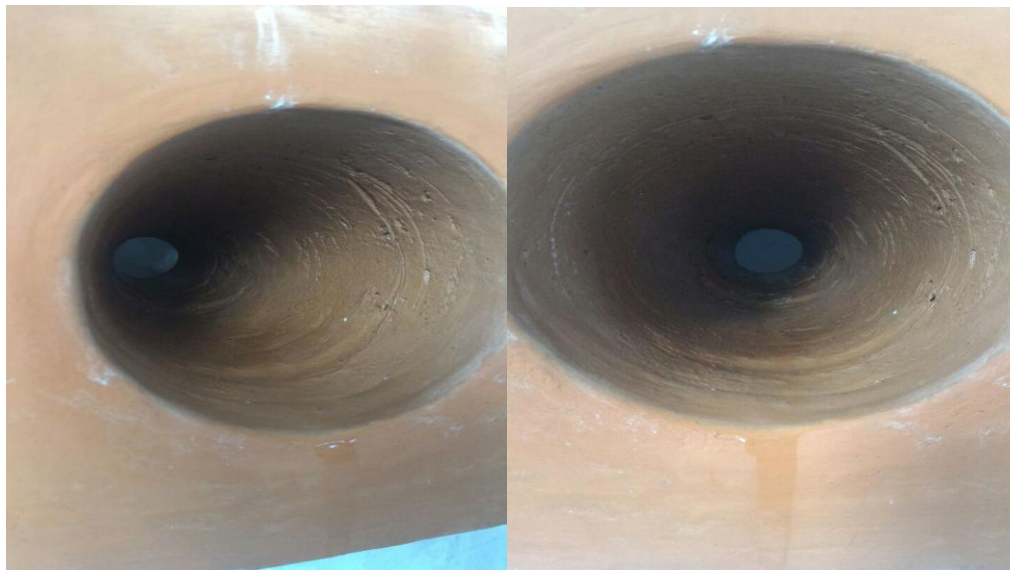
Figura 24: Água infiltrada na face interna do cone
