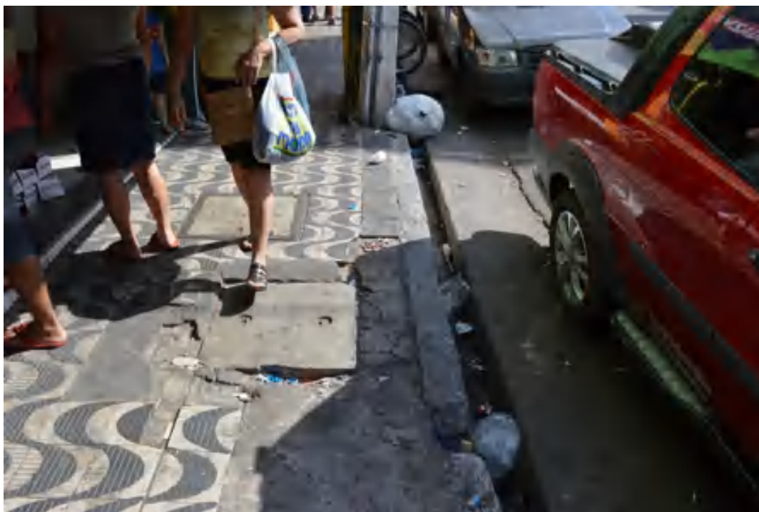
Figura 59 – Falta de manutenção nas calçadas.
