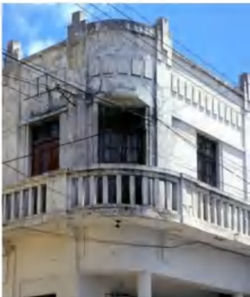
Imagem 17: Retângulos em repetição formando um colar (fechamento) nesta fachada com pilastras coroadas por prismas retangulares em gradação (sobreposição). Sobrado comercial com esquina boleada típico da primeira metade da década de 1940 no centro de Campina Grande, PB Fonte: Lia Monica Rossi e José Marconi Bezerra de Souza
