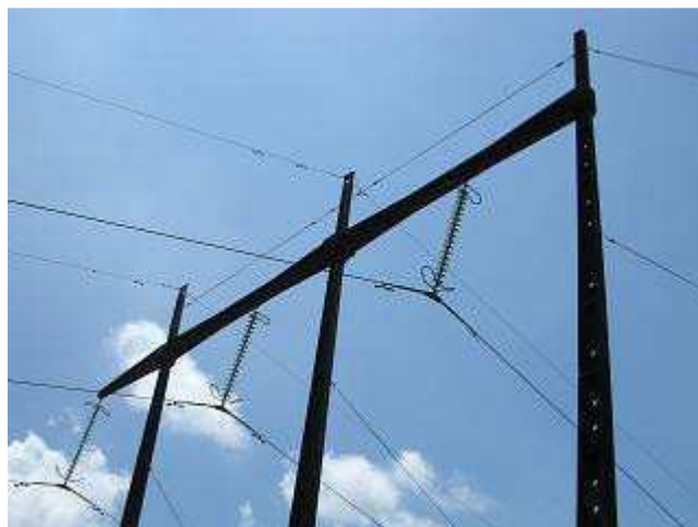
Figura 3.9 – Estrutura em ângulo (suspensão) – Foto Chesf Luiz Carlos
