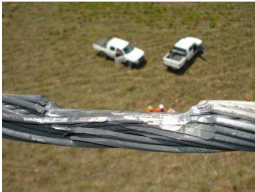
Figura 3.51 – Cabo danificado por espaçador. Foto Chesf Nailton
