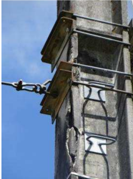
Figura 3.21 – oxidação interna de ferragens – Fonte Chesf.
