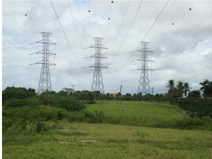
Figura 3.53 – Esferas de Sinalização aérea em cabos pararraios. Foto Chesf Luiz Carlos
