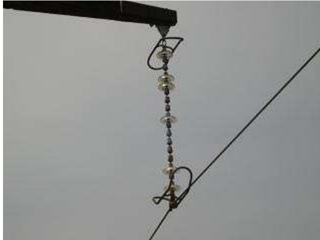
Figura 3.26 – Quebra de isoladores por vandalismos. Foto Chesf Josué.
