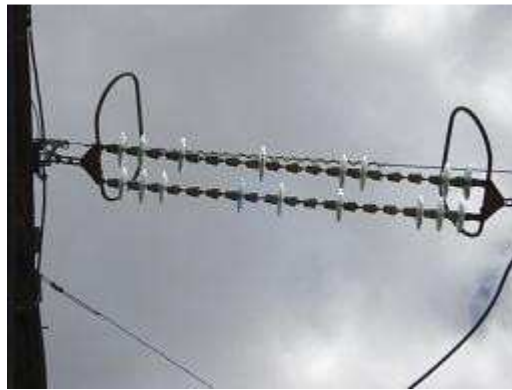
Figura 3.27 – Quebra de isoladores por vandalismos. Foto Chesf Josué.
