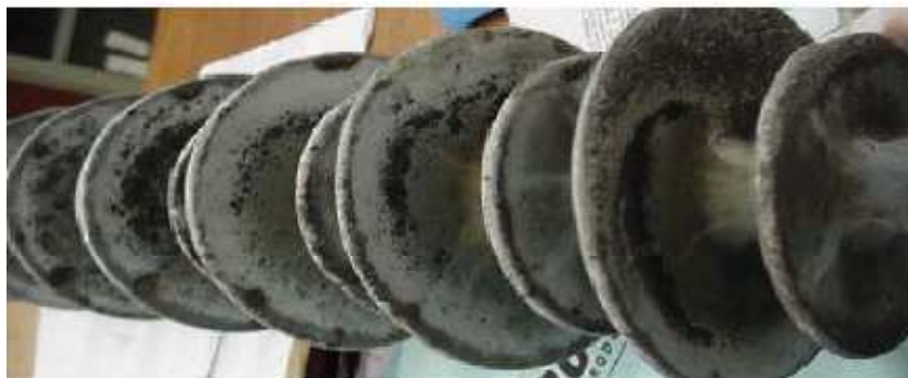
Figura 3.35 – Isolador polimérico contaminado por fungos. Foto CIGRÉ 2008.
