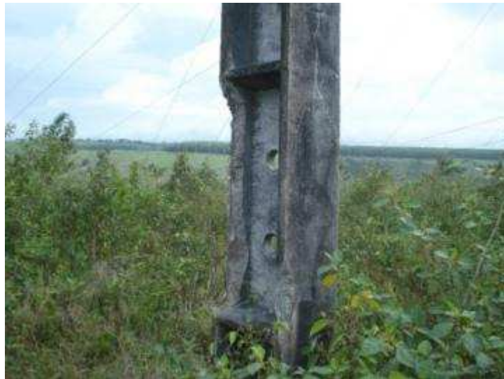
Figura 3.22 – vandalismo com roubo de ferragens – Fonte Chesf.
