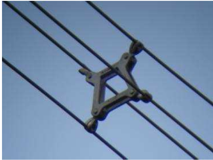
Figura 3.50 – Espaçador danificado. Foto Chesf Cleuber
