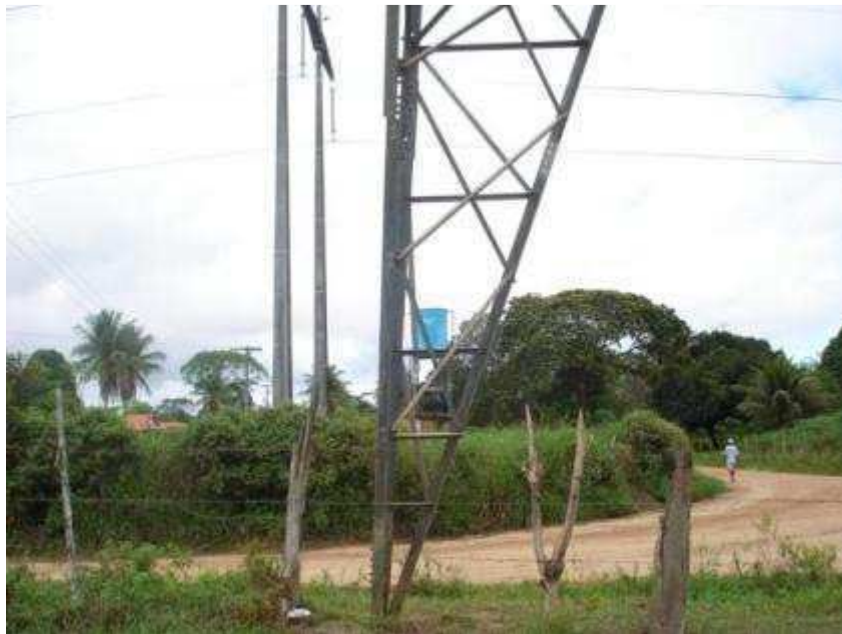
Figura 3.17 – Vandalismo em estrutura (roubo de peças). Foto Chesf Cleuber
