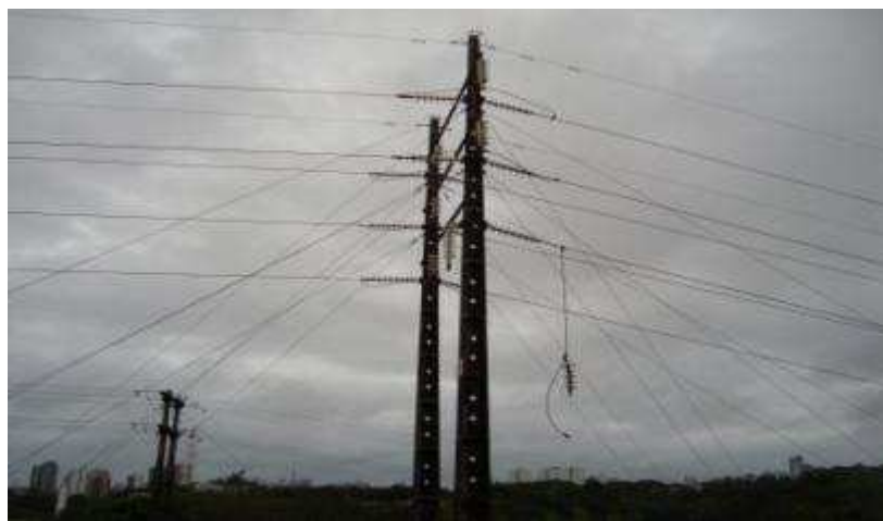
Figura 3.46 – Rompimento de cabo por descarga atmosférica. Foto Chesf Josué
