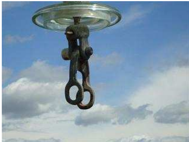
Figura 3.43 – Cadeia desatrelada por erro de montagem. Foto Chesf Nailton.
