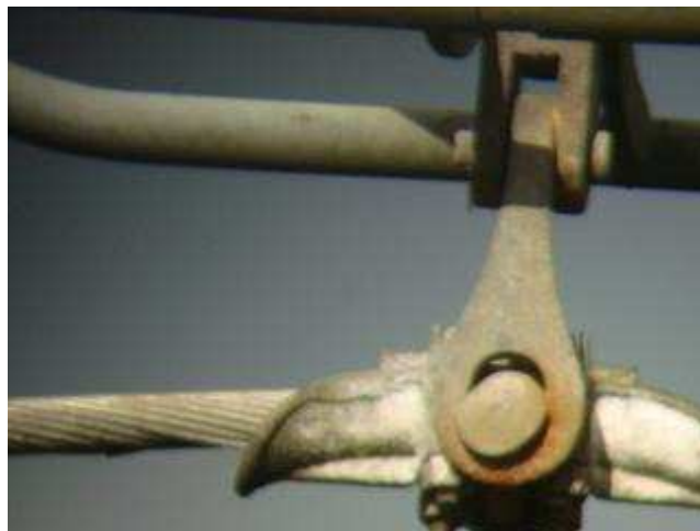
Figura 3.48 – Rompimento de tento por vibração eólica. Foto Chesf Cleuber
