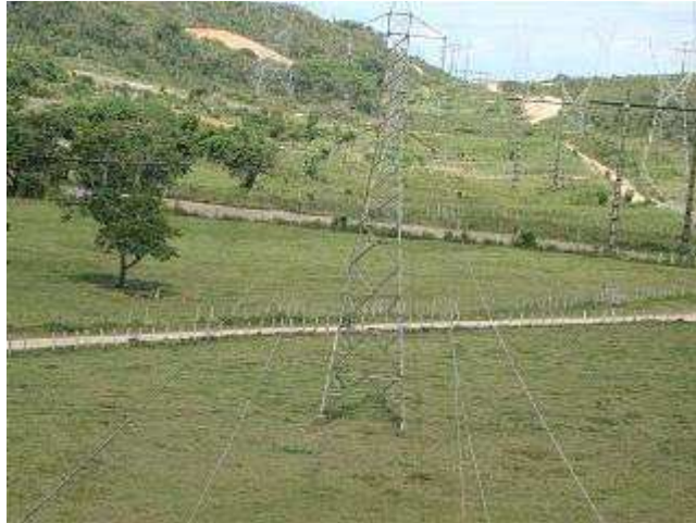
Figura 3.42 – Cadeia desatrelada por erro de montagem. Foto Chesf Nailton.
