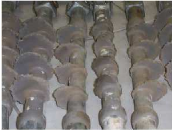
Figura 3.33 – Isolador polimérico agredido por aves. Foto CIGRÉ 2008.
