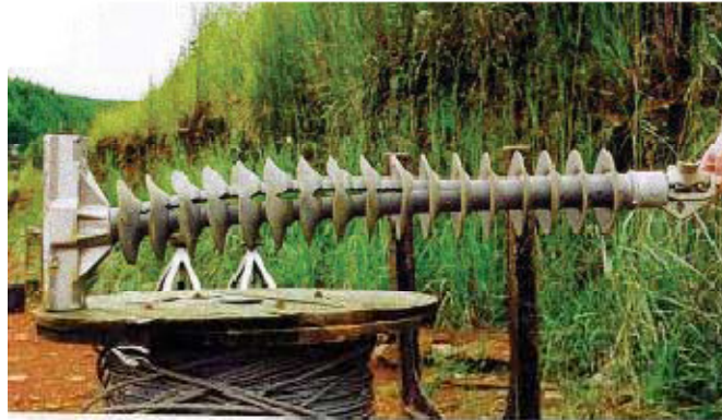
Figura 3.39 – Isolador polimérico rompimento por esforço mecânico inadequado. Foto CIGRÉ 2008.
