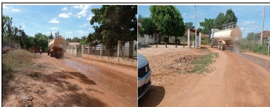
Figura 6- Caminhões fazendo a umectação das vias de acesso da obra no sítio Inveja
