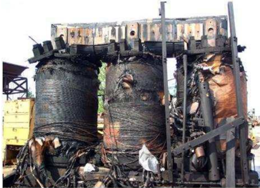
Figura 1 – Estrutura interna de um transformador de grande porte danificada por uma falta. (Rosentino, 2010).
