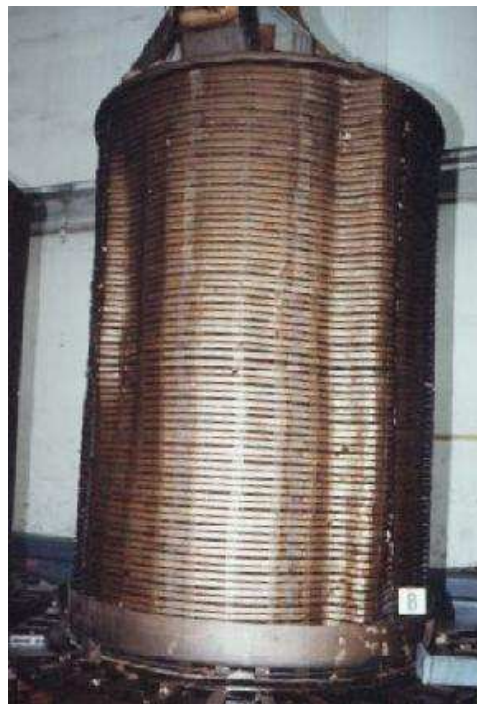
Figura 10 – Enrolamento danificado por deformação forçada (forced buckling). Modificado de (Rosentino, 2010).
