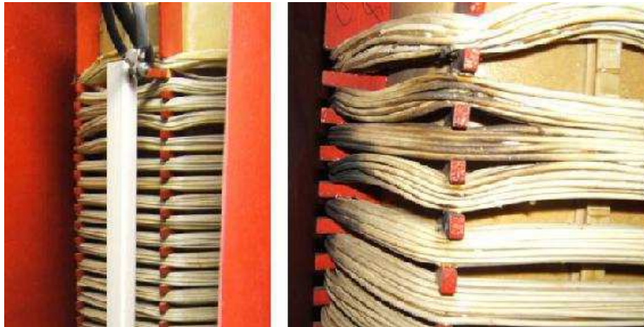
Figura 17 – Efeito bending em um transformador real. (CHESF/UFU, 2009).
