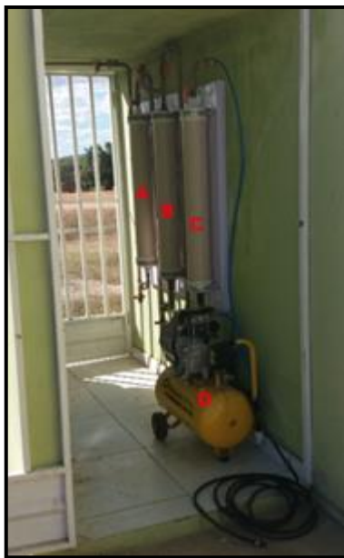
Figura 9 - Sistema de purificação de biogás. A) Solução química; B) Filtro de H 2 S; C) Coluna de água; D) Compressor de gás
