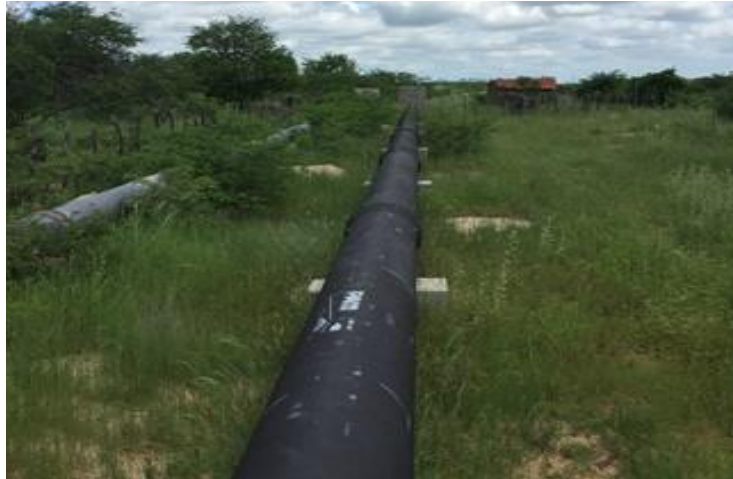
Figura 14 - Adutora Manuel Torres – Sistema Piranhas/Caicó
