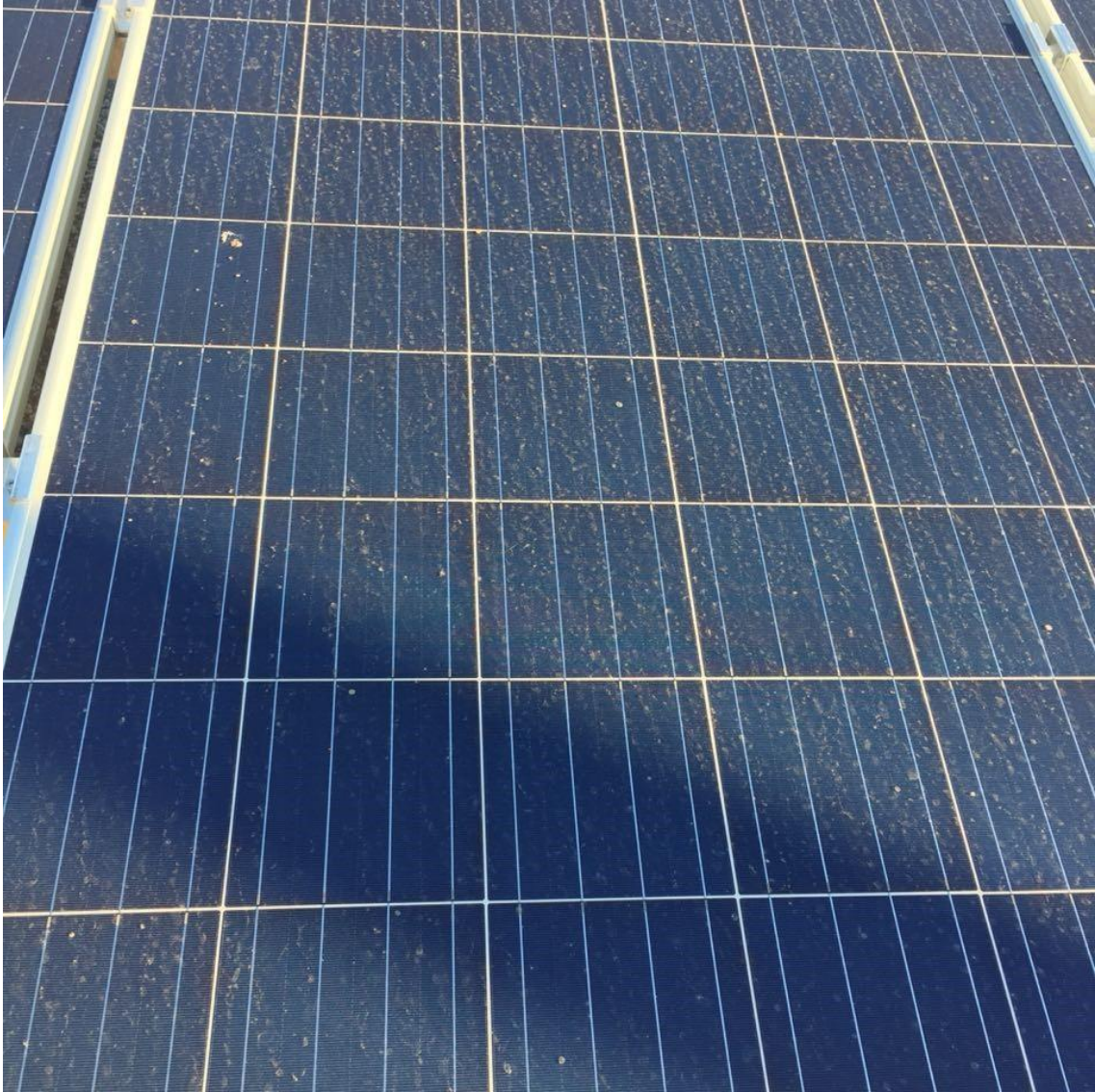
Figura 3 – Módulos fotovoltaicos utilizados na UFV (Fonte: Autoria própria, 2018).
