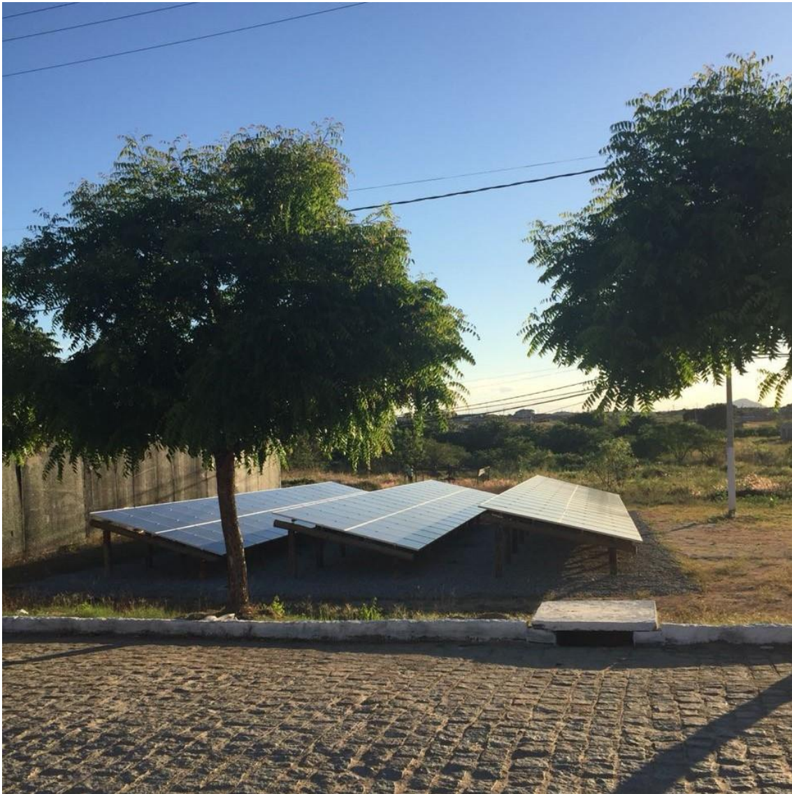
Figura 4 – Módulos fotovoltaicos utilizados na UFV (Fonte: Autora, 2018).
