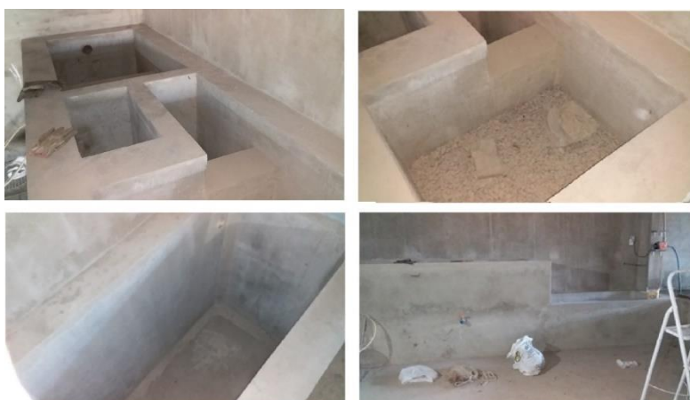
Figura 13 – Sistema de tratamento de efluentes
