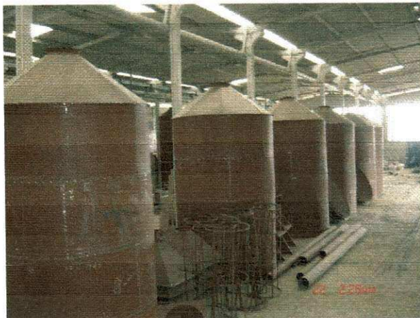
Figura 7 – Silos de expedição
