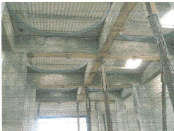
Figura 5 – Estrutura dos Silos dosadores
