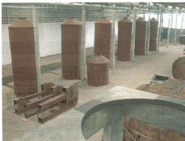
Figura 6 – Silos dosadores e cabeça dos elevadores.
