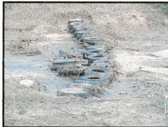
Figura-6-Barragem 2 após as primeiras chuvas do local
