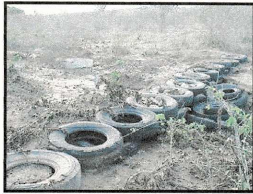
Figura-4-Barragem-1, vista a jusante após duas chuvas intensas no mês de jan./05
