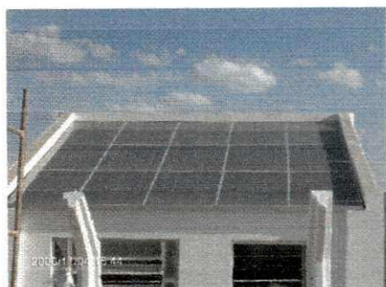
Figura 28 – Vista Frontal do Conjunto de Painéis Fotovoltaicos
