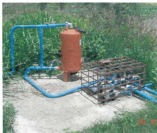
Figura 5. Cabeçal de controle composto por filtro de areia, motobomba, filtro de disco, filtros de tela e manômetros analógicos
