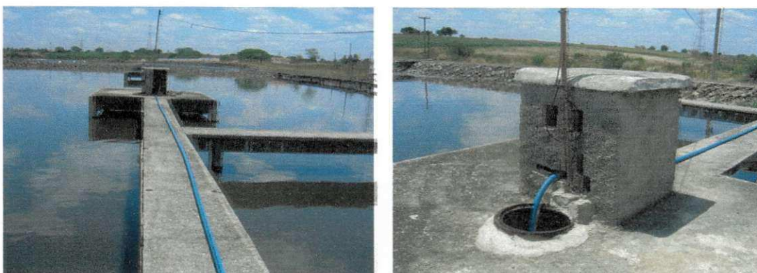
Figura 2. Captação do efluente final das lagoas de estabilização usado no experimento, ETE de Campina Grande.
