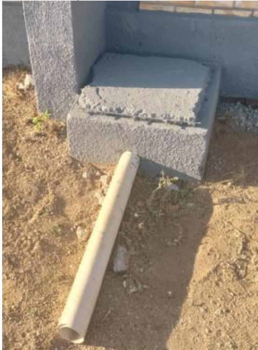
Figura 12 - Condutor horizontal do Bloco 3.
