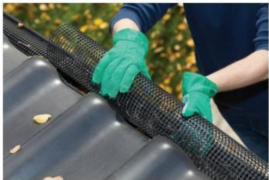
Figura 4 - Calha com grade.
