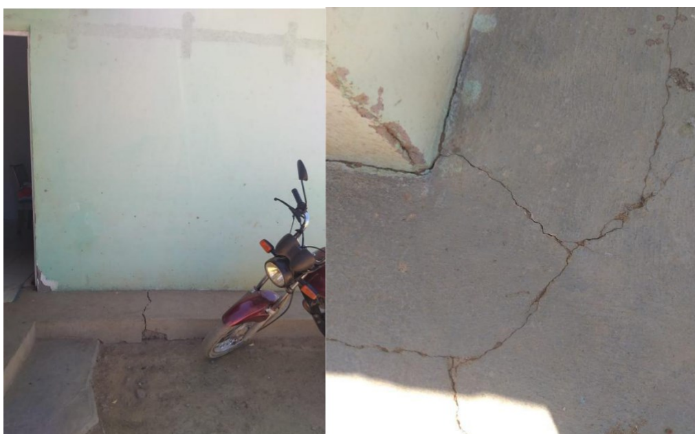
Figura 10 - Danos físicos causados em residência pelo PISF.
