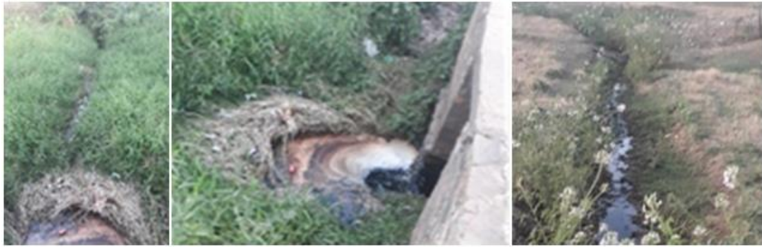
Figura 12. Córrego com esgoto que deságua no Rio Salgado.
