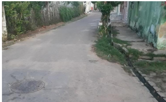
Figura 8. Esgoto a céu aberto em via com rede coletora de esgoto.
