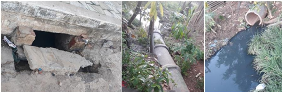
Figura 9. Esgoto lançado no sistema de drenagem urbana.
